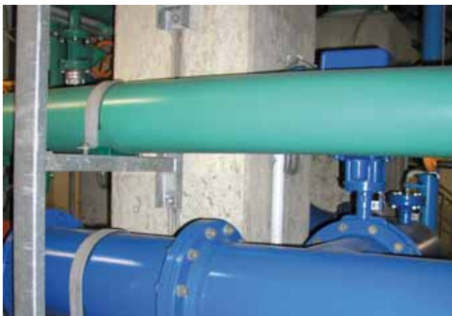
Rohrleitungsunterstützung an senkrechter HZA-Schiene
