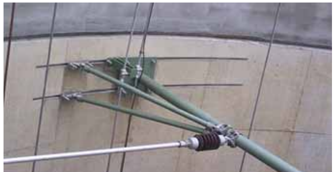
Befestigung von Oberleitungen im Eisenbahntunnel
