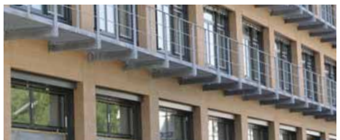
Befestigung von Fluchtwegen/Fluchtbalkonschwert
