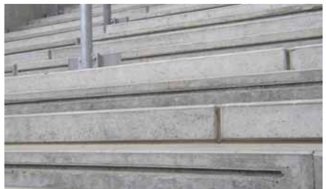
Befestigung Geländer, Stehtribüne RheinEnergieStadion/Köln
